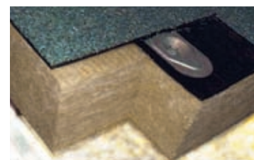
Mechanické kotvení kovovým šroubem s přitlačnou podložkou v přesahu asfaltového pásu (obr. 46)
