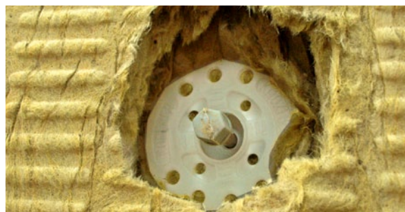
Ukázka špatně zapuštěné hmoždinky (obr. 31)
