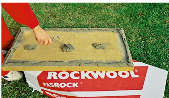
Nanášení terčů a válečků u desek Fasrock a Frontrock MAX E (obr. 15)
