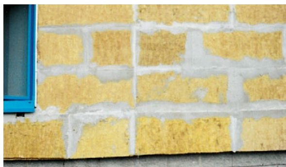
Nevhodné „vyplňování“ spár lepidlem (obr. 21)
