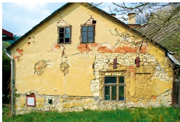
Nevhodný podklad pro zateplování – nutno odstranit trhliny (obr. 11)
